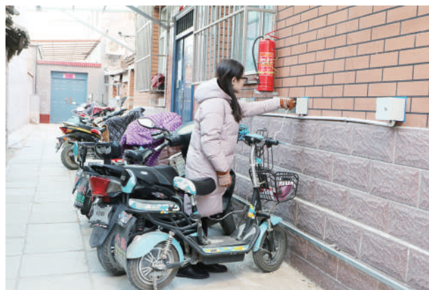
居民自建的电动车充电站
